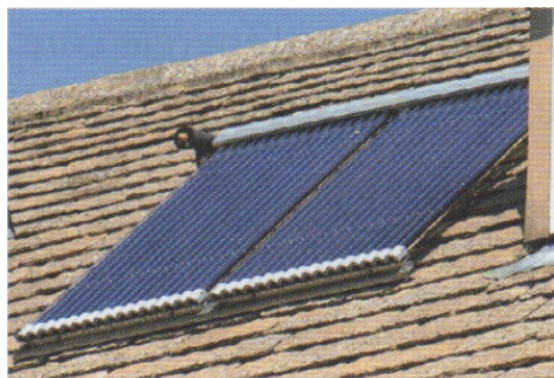
Panneau solaire thermique
